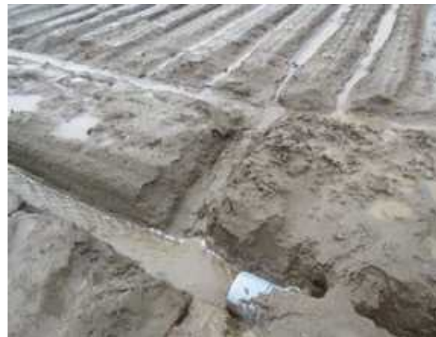
大雨により水が溜まるので 明渠等による排水が必要
